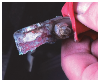
腐食で一部が溶けたターミナル
